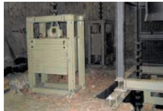
Führungsseilspanngewicht mit Führungsrahmen an der 840 m Sohle
